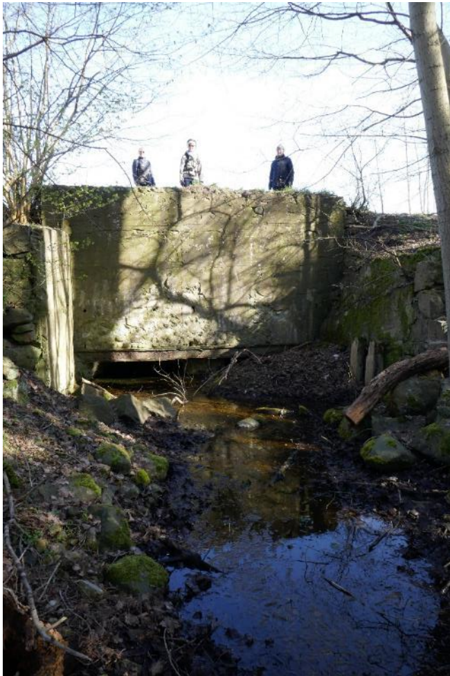
Foto: Hjulgraven til den nu nedrevne Øresø vandmølle i sin seneste, betonforstærkede udgave. Foto: AF april 2020.
